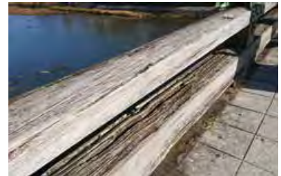
生物劣化（腐朽菌）の一例
